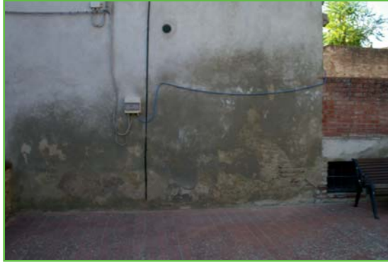
Värin muutos, lämmöneristyksen alentuminen.
