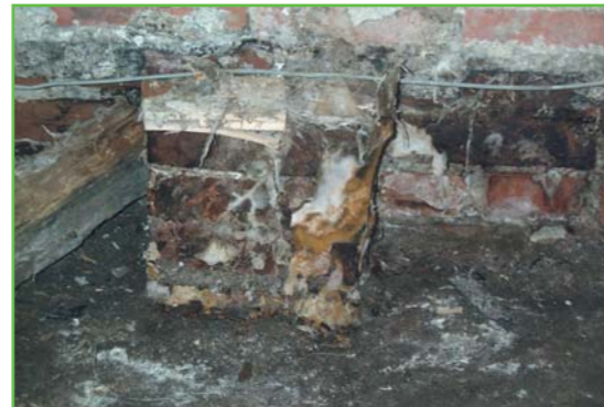
Homeen muodostuminen ja rakenteiden vaurioituminen.
