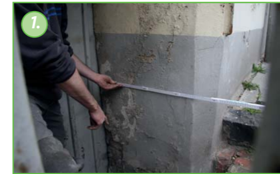
Tämä muuraus on vuodelta 1750 ja nykyinen laasti on vaurioitunut. Suola- ja kosteuspitoisuudet ovat erittäin suuret.
