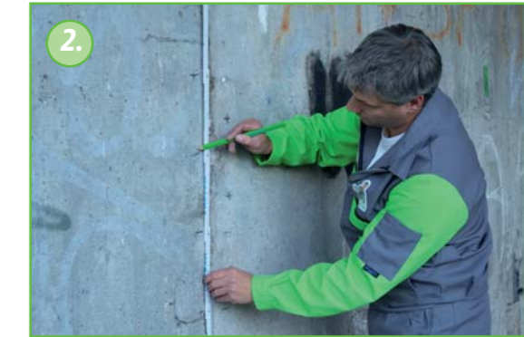
2. Merkkää paikat joihin porausreiät porataan. Porausreiät sijoitetaan pitkin halkeaman suuntaa molemmiin puolin n. 10 cm–15 cm etäisyyksin toisistaan.
